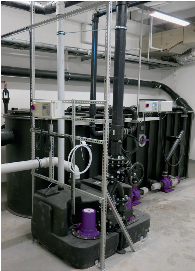
Helautomatisk fettavskiljare och pumpstation installerad på galleria i Växjö
