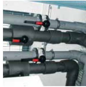
ABS SuperFLO rörsystem installerat med vridspjäll typ FKOA.
